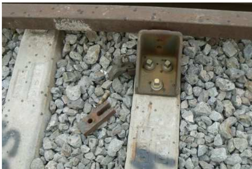
Foto 14. Brida de fijación del contrarriel aflojada en Pk 16,900
