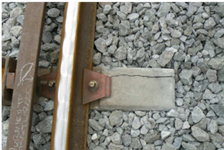
Foto 18. Durmiente agrietada longitudinalmente en Pk 16,848
