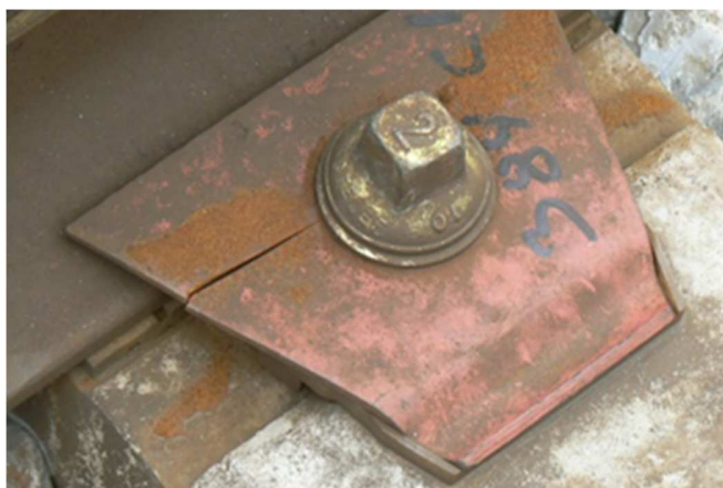
Foto 23. Fijación Nabla agrietada en Pk 8,250
