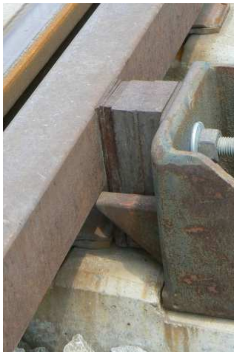
Foto 15. Apoyo del contrarriel sobre 3 mm en extremo del soporte (curva 3)
