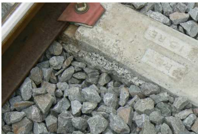
Foto 16. Durmientes con moldeado lateral anormal en Pk 7,020
