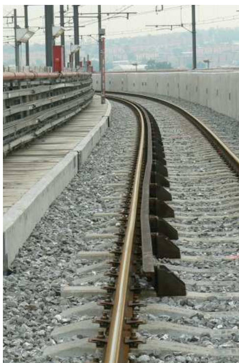
Foto 12. Contrarriel de la curva 27 vía 2
