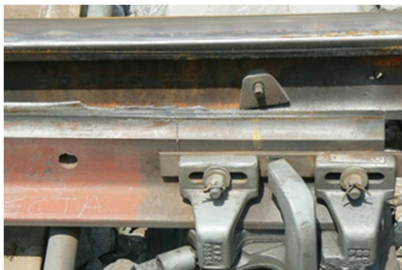
Foto 36. Aguja mellada en estación de Tlahuac
