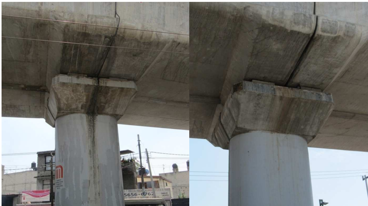
Foto 46. Problema de drenaje entre dos tramos
