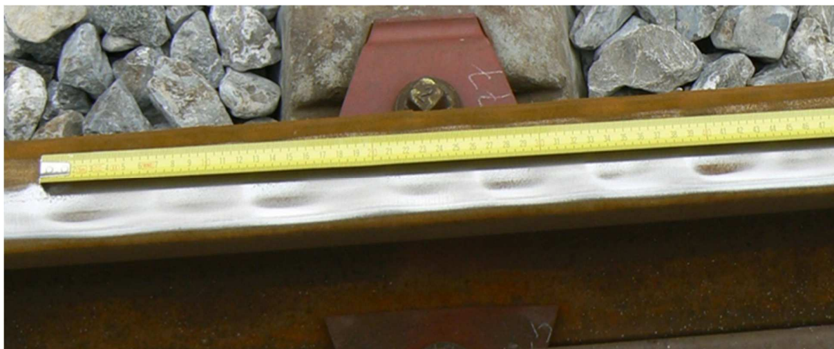
Foto 2. Desgaste ondulatorio de amplitud 6-7 cm vía 2 Pk 10,905
