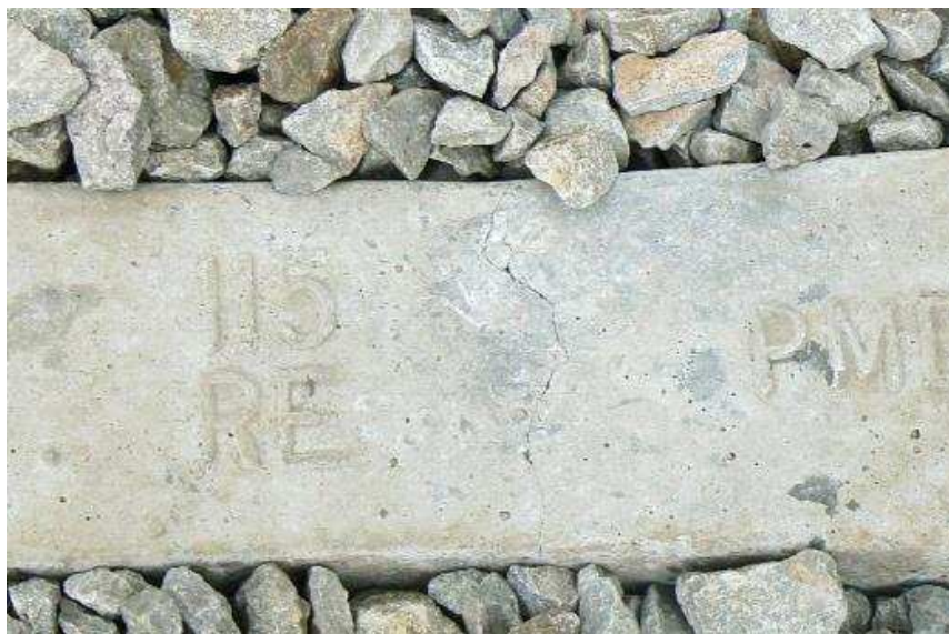
Foto 19. Durmiente agrietada transversalmente en Pk 6,985
